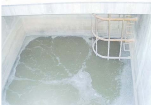
微細気泡発生装置の運転状況
