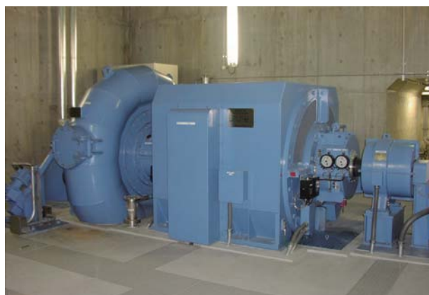
施設管理用水力発電設備（日吉ダム管理所）
