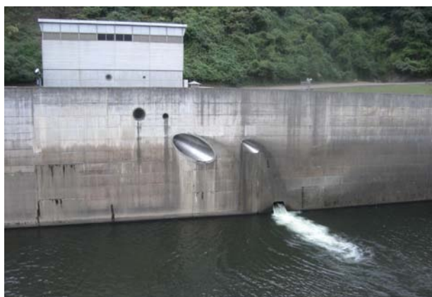
管理用発電所（日吉ダム管理所）
